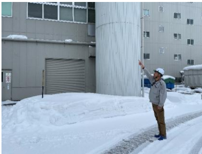
<ボイラ設備（異常排煙）>
