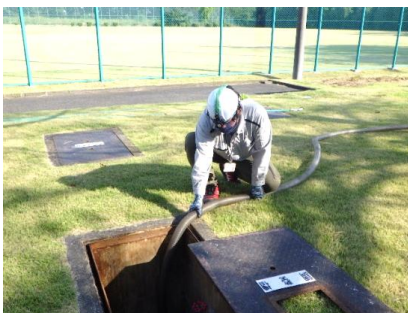
<合併処理浄化槽（放流水異常）>
