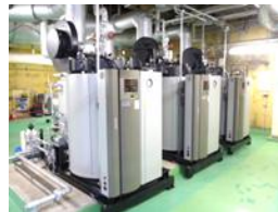
重油焚き加湿蒸気供給方式
